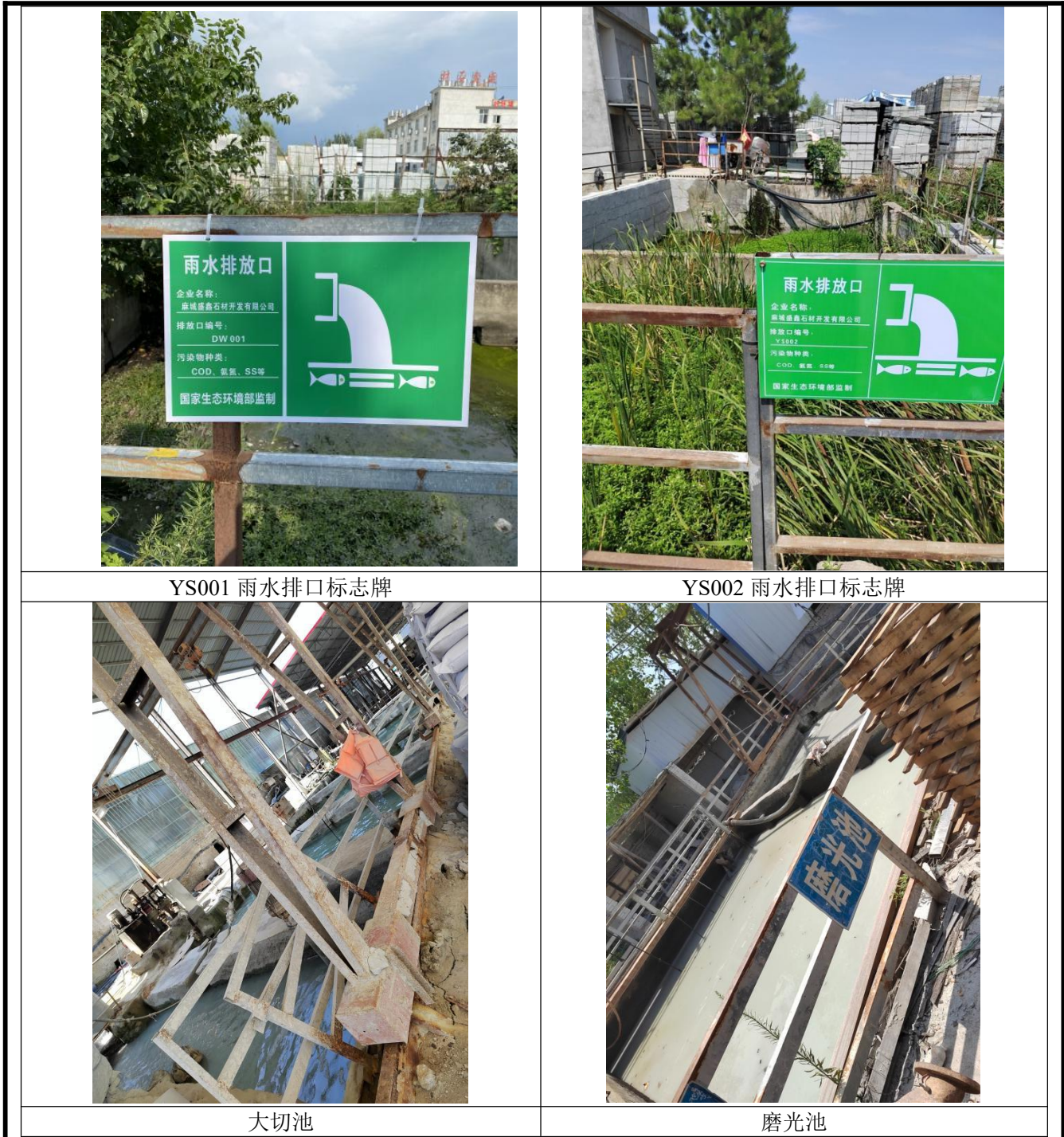
图 8 项目废水防治措施现场照片
