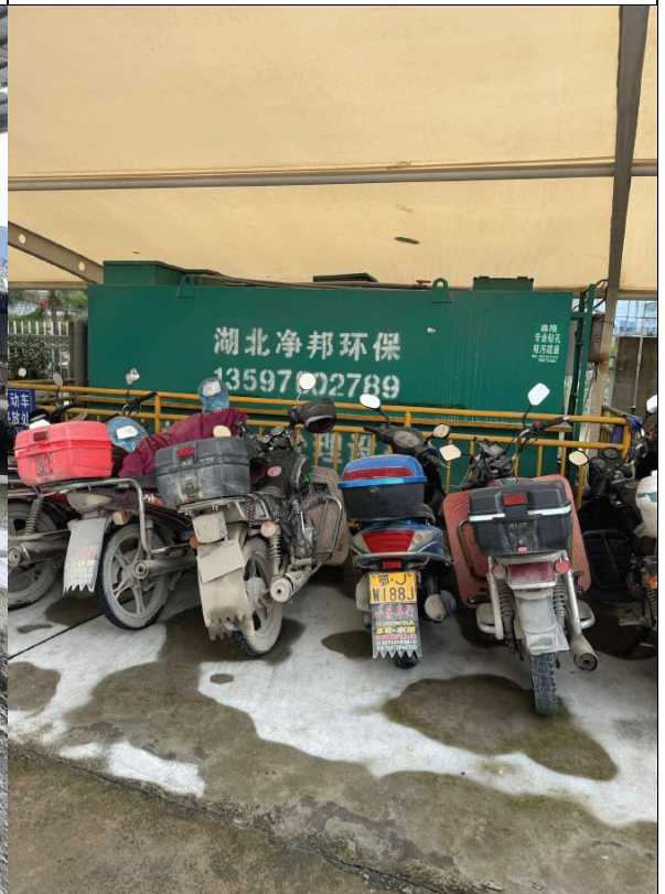
生活污水处理设施
