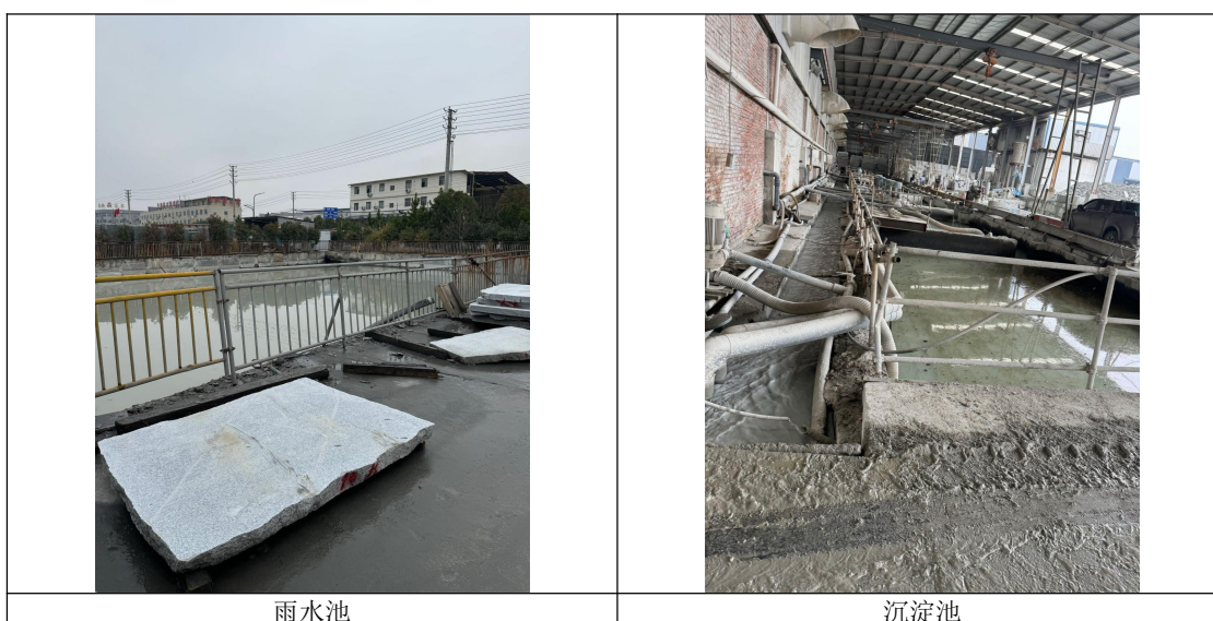
项目废水防治措施现场照片
