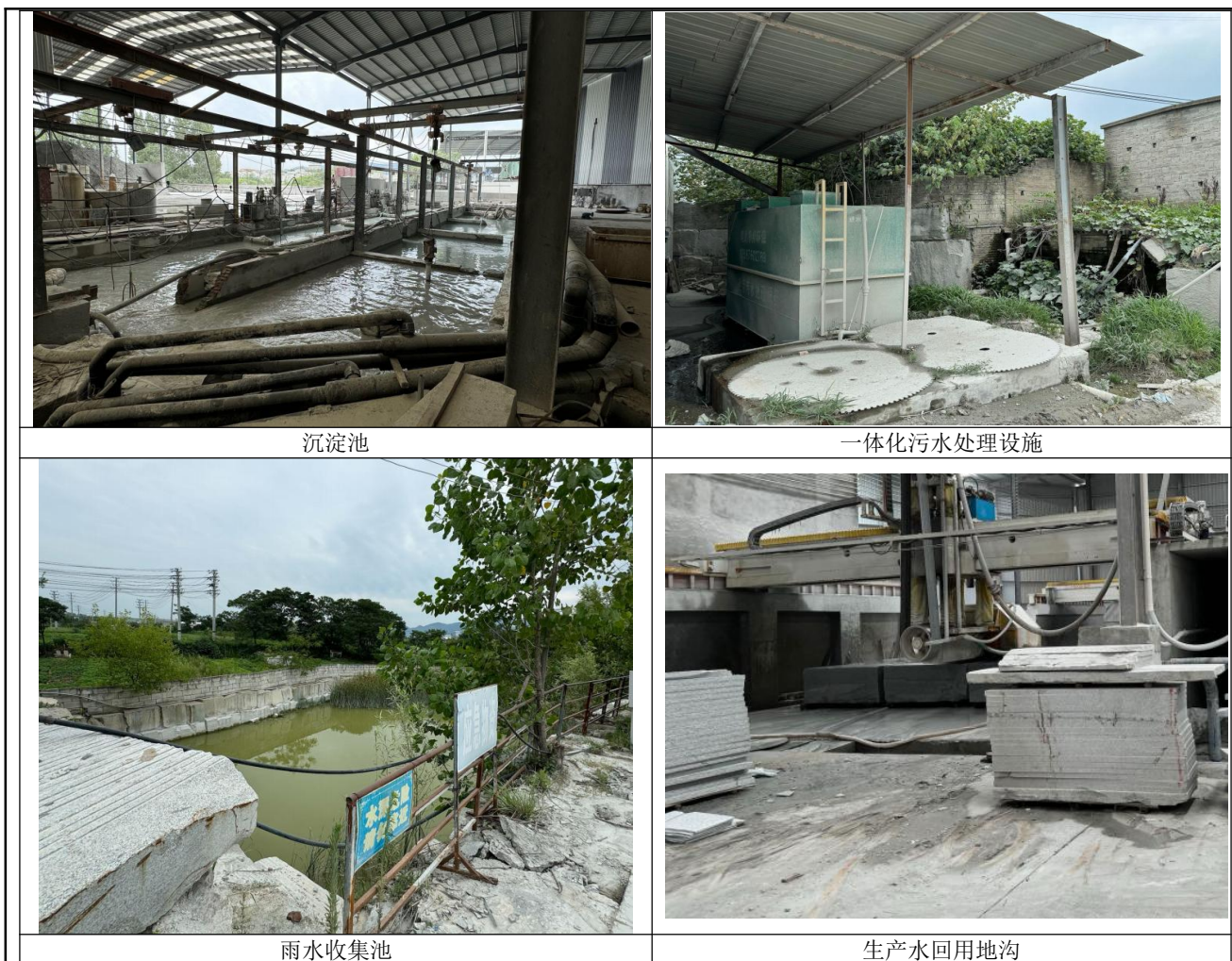
图 6 项目废水防治措施现场照片
