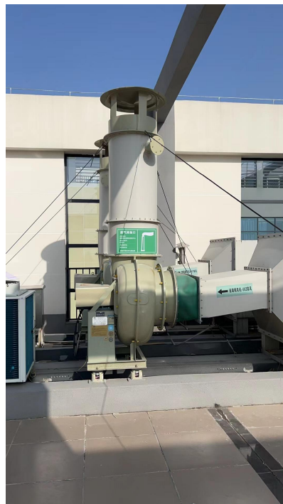
废气排气筒及标识牌
