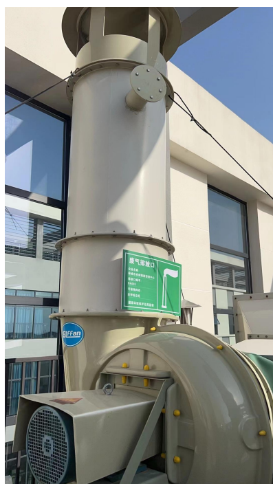
废气排气筒及标识牌
