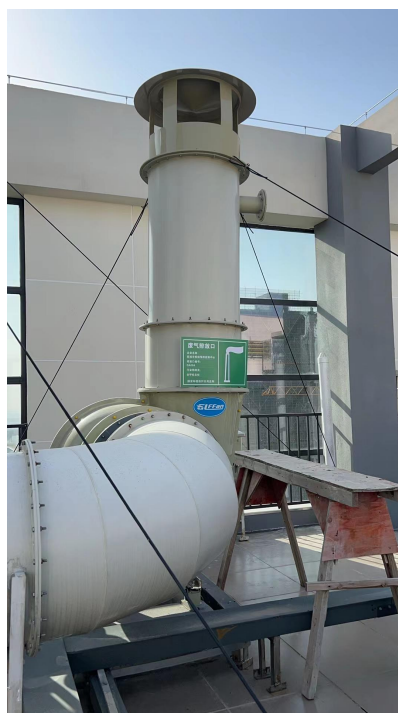
废气排气筒及标识牌
