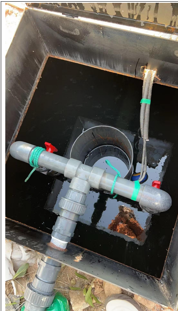
污水处理水池内部
