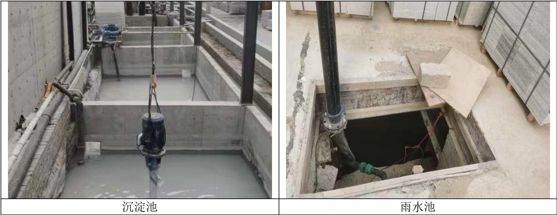
项目废水防治措施现场照片
