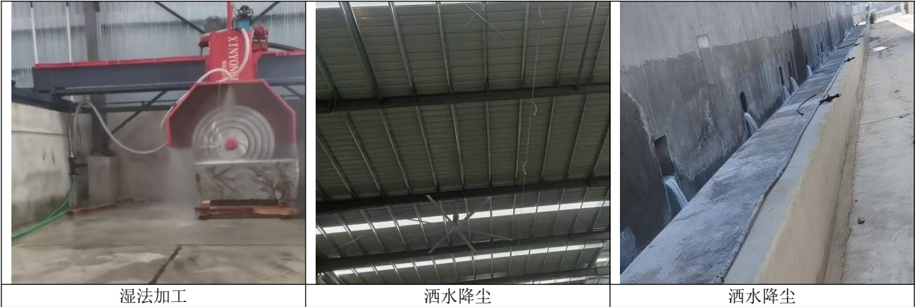
图 8 项目废气防治措施现场照片
