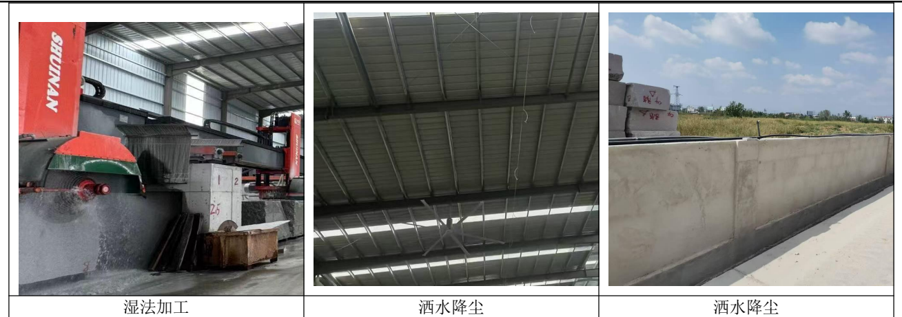
图 6 项目废气防治措施现场照片
