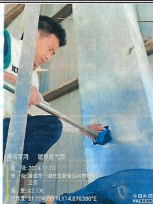
◎1DA001 破碎废气处理 设施排气筒
