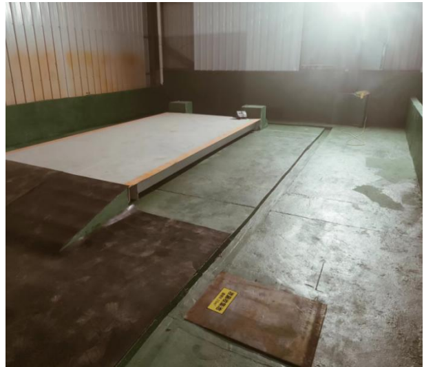
车间内导流沟和泄漏收集池
