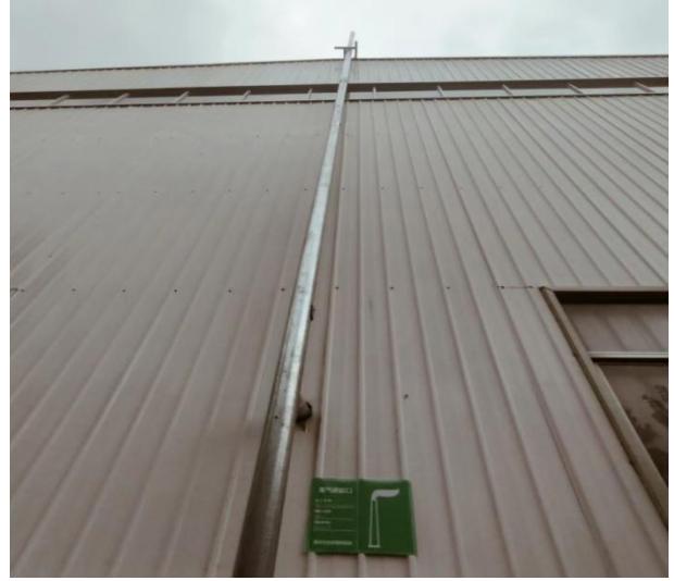
废气排口及标识牌
