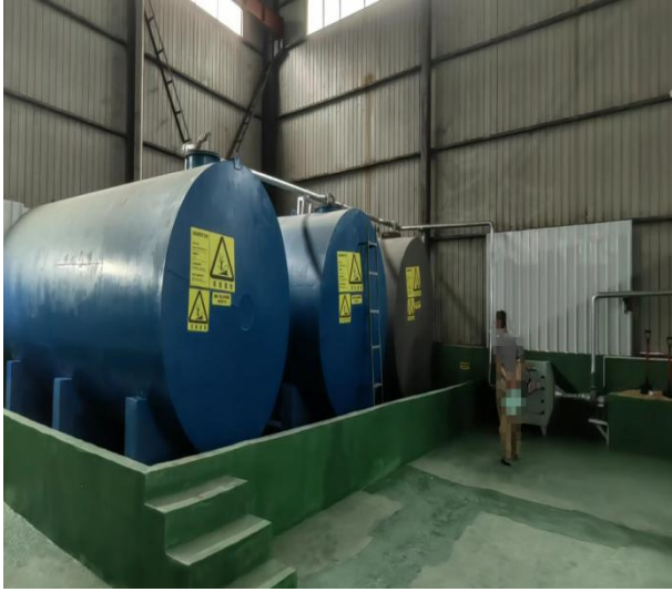
废气收集管道和处理设施
