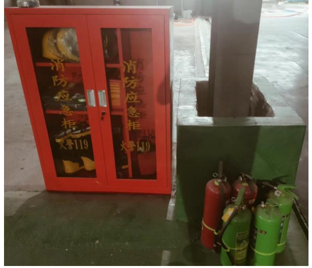
应急柜及应急设备
