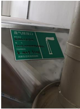
污水处理站排气筒标识牌
