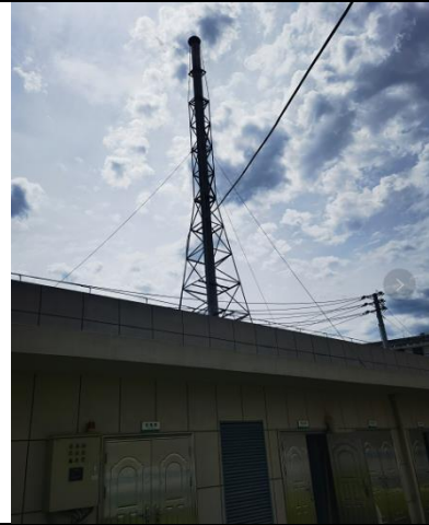
污水处理站废气排气筒
