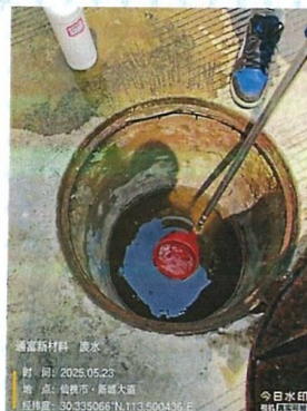
★1 DW001 车间化粪池 出口 W1
