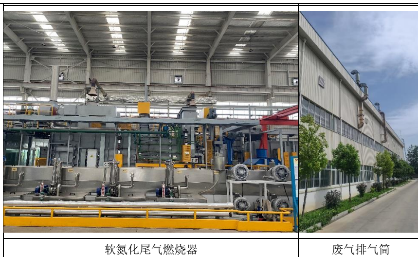
图 3-1 废气处理设施图
