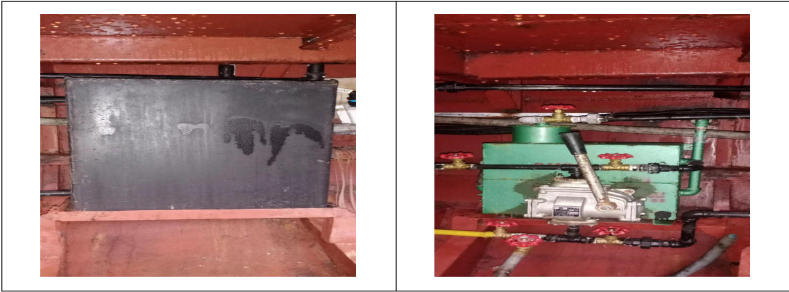
附图 6 项目船舶含油废水暂存设施照片
