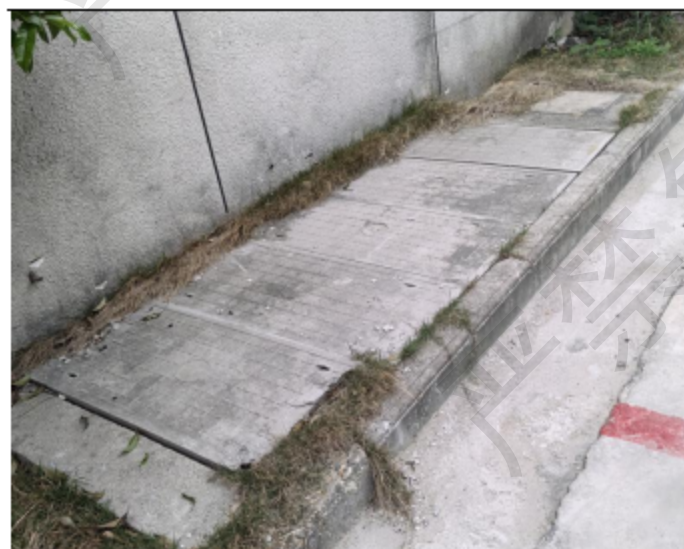
食堂废水隔油池
