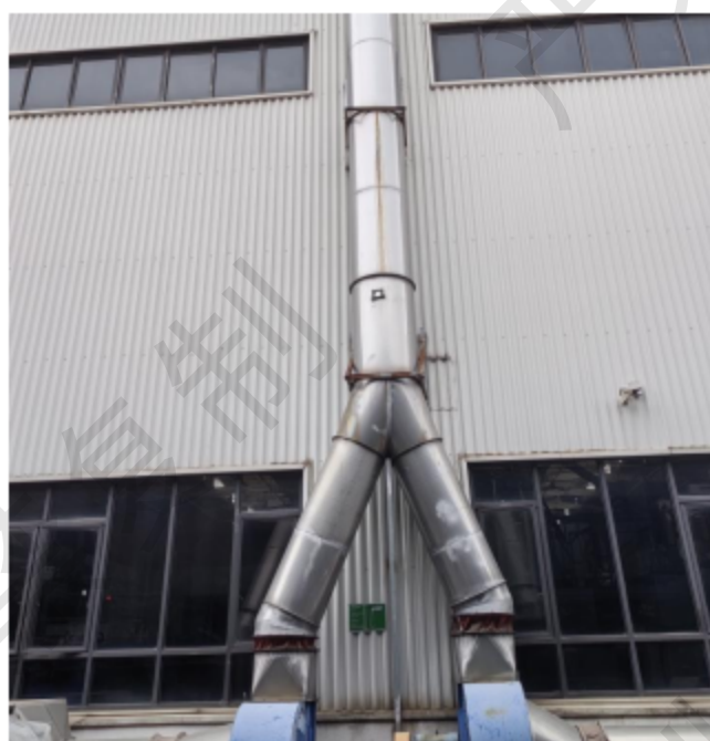
注塑废气排气筒 DA001
