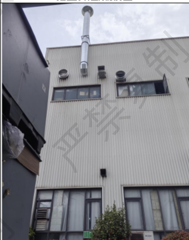
喷胶工序排气筒 DA002
