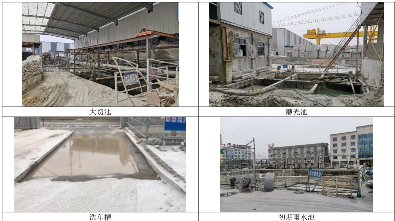
图 4 项目废水防治措施现场照片
