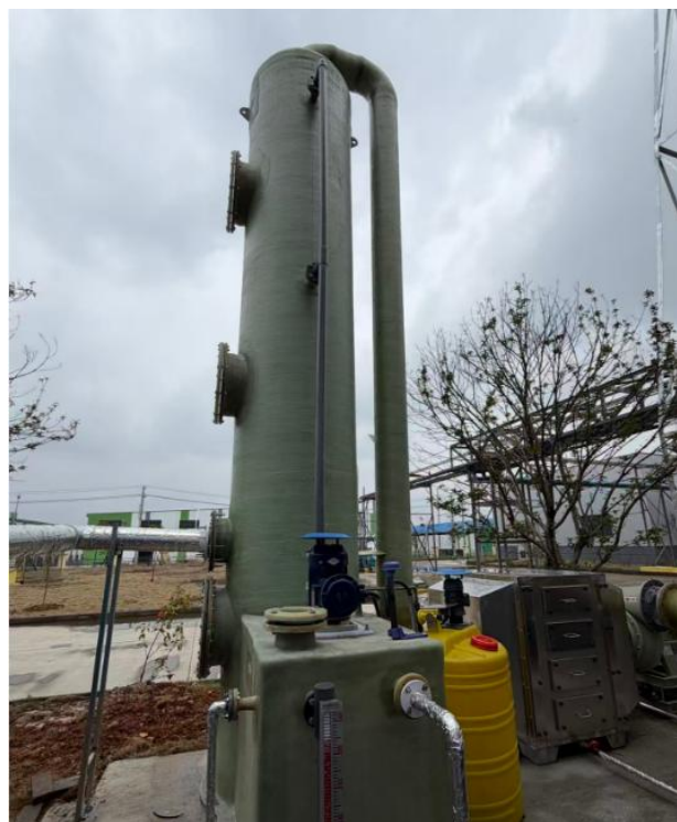
喷淋塔+除雾器+活性炭箱
