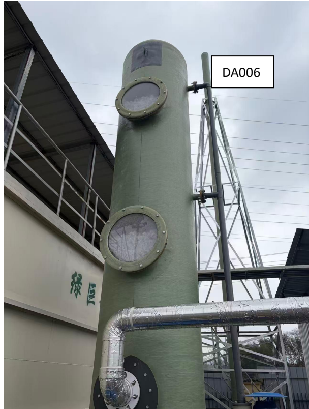
污水处理站废气排气筒
