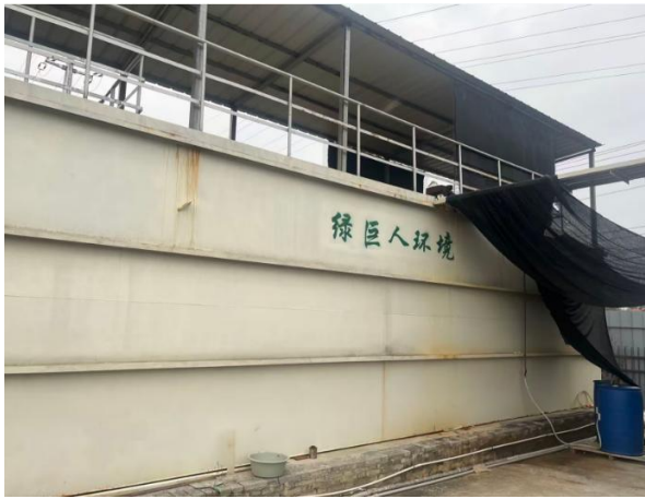
项目污水处理站
