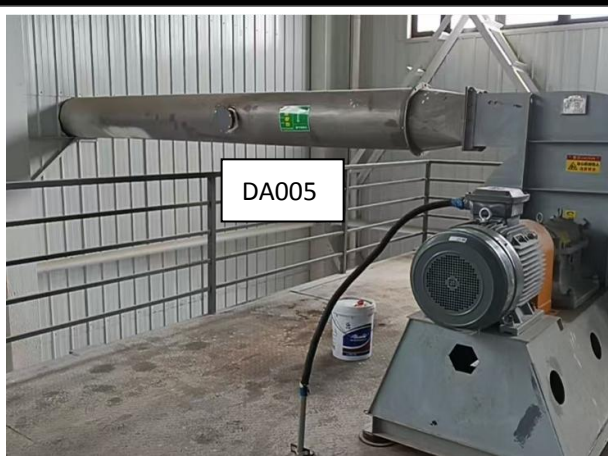
喷雾干燥塔（大）排气筒
