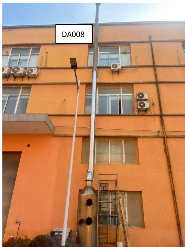
租赁区喷雾干燥塔排气筒
