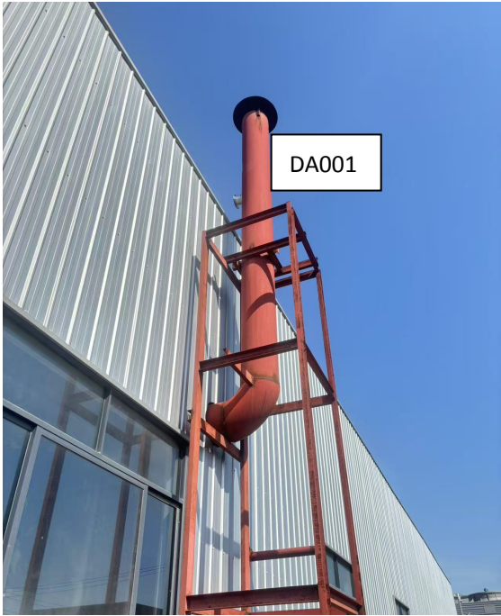
动力车间蒸汽发生器排气筒
