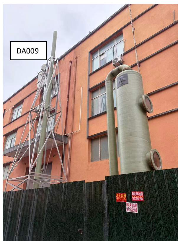
租赁区提取车间有机废气排气筒
