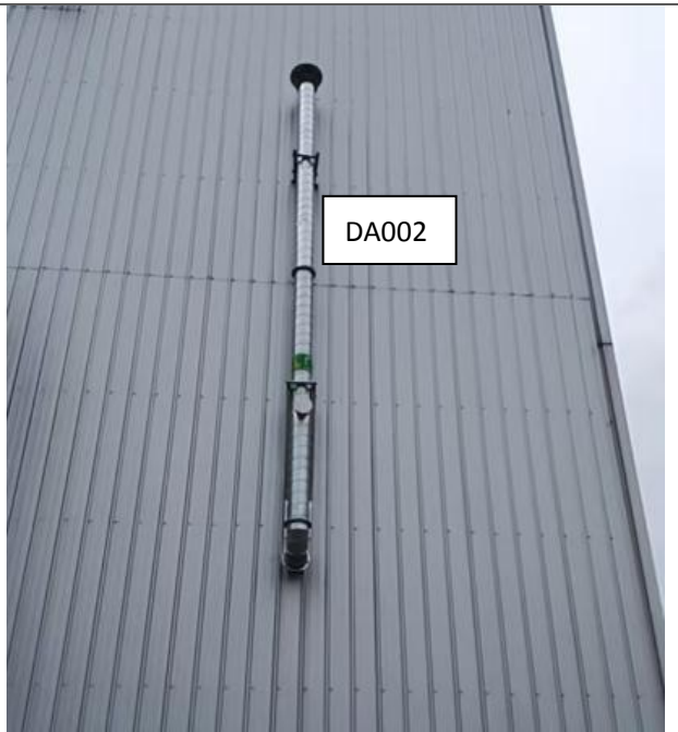
喷雾干燥塔自带天然气燃烧器排气筒
