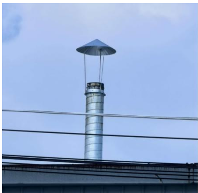
隧道炉排气筒
