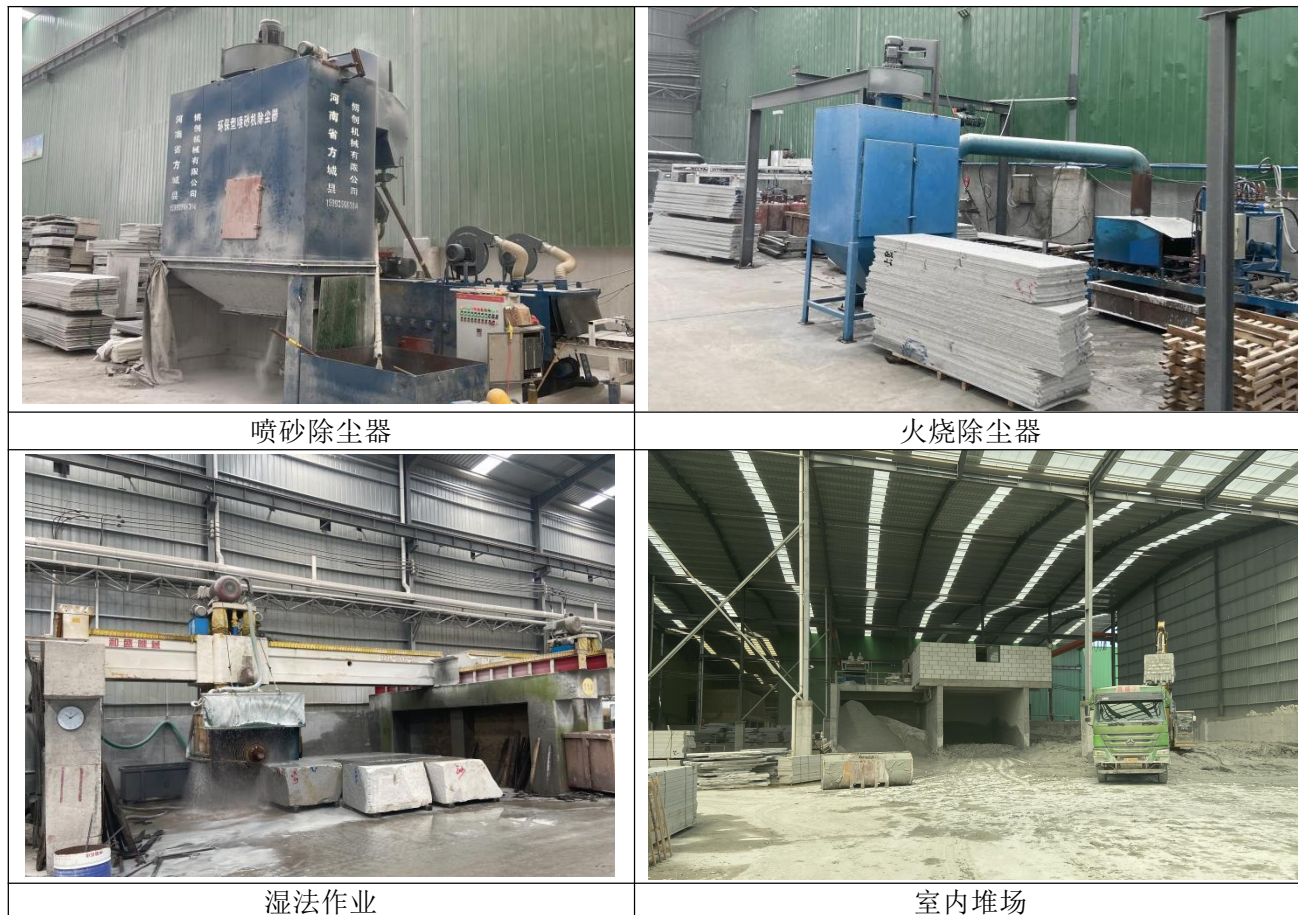
图3 项目废气治理设施照片
