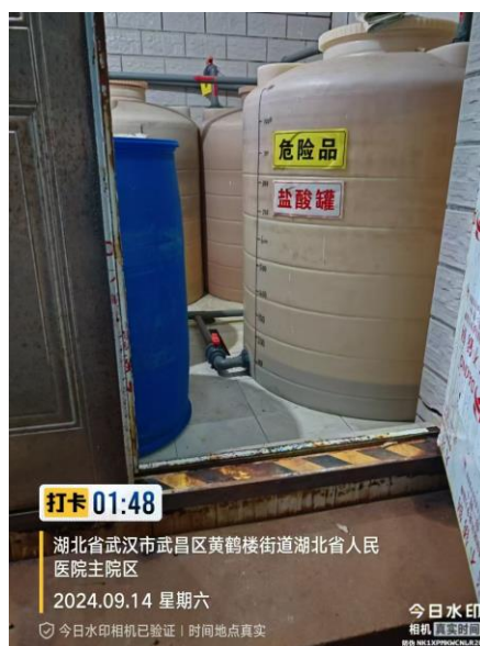
图 4-5 污水处理站化学品储存措施
