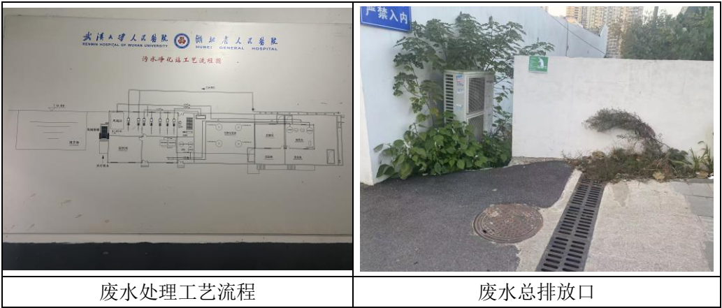
图 4-2 项目废水防治措施现场照片
