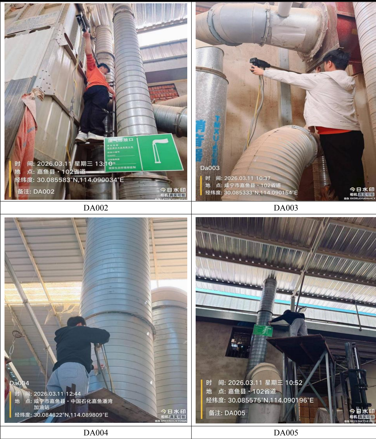
图 1 项目废气防治措施现场照片
