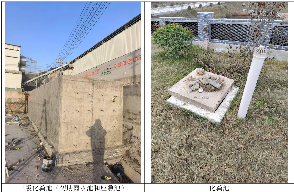
图 5 项目废水防治措施现场照片
