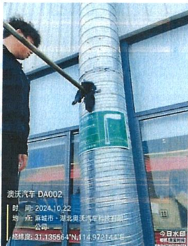
02 DA002 注塑废气排气筒
