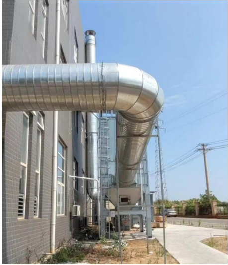
DA001废气收集管道、处理设施和排口
