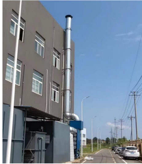
DA002废气处理设施和排口
