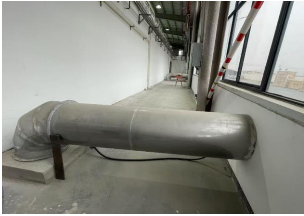
辐照车间排风管
