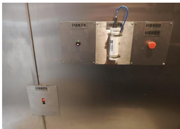
辐照车间内光电开关、急停按钮 6
