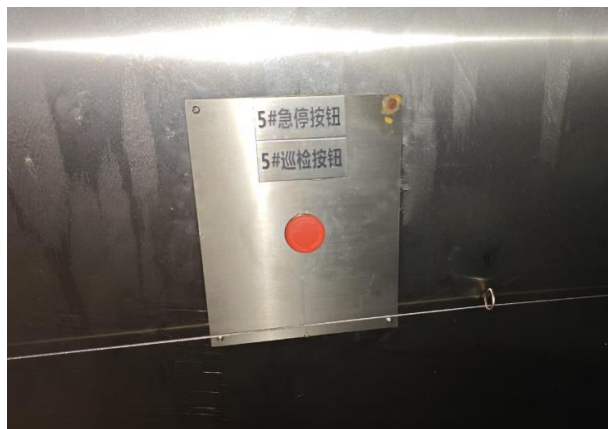
辐照车间内急停按钮 5
