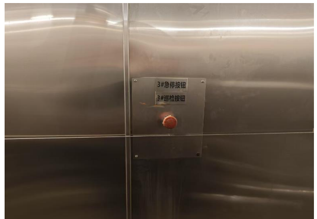
辐照车间内急停按钮 3
