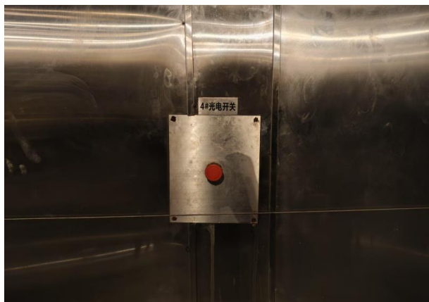
辐照车间内光电开关 4
