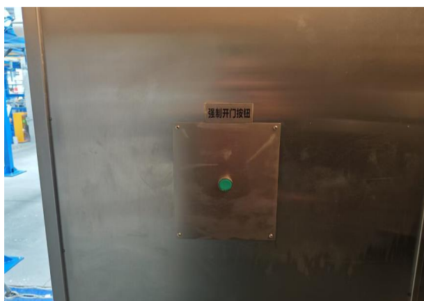
辐照车间内强制开门按钮
