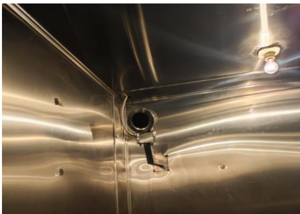
辐照车间内摄像头 1
