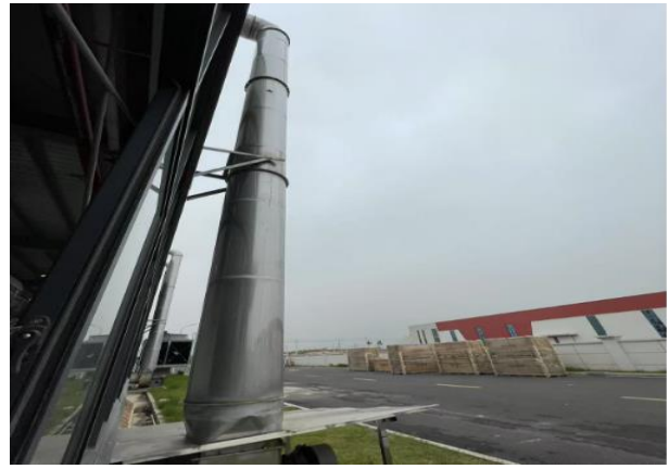
辐照车间排放管至车间顶部
