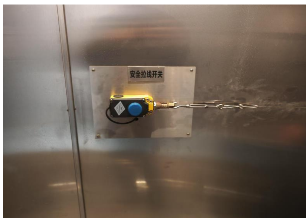
辐照车间内安全拉线开关
