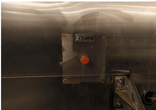
辐照车间内急停按钮 2
