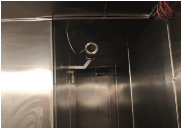
辐照车间内摄像头 5
