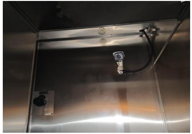
辐照车间内摄像头 6
