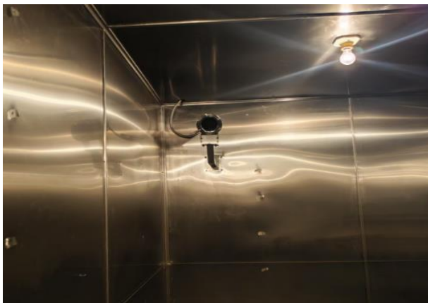
辐照车间内摄像头 3
