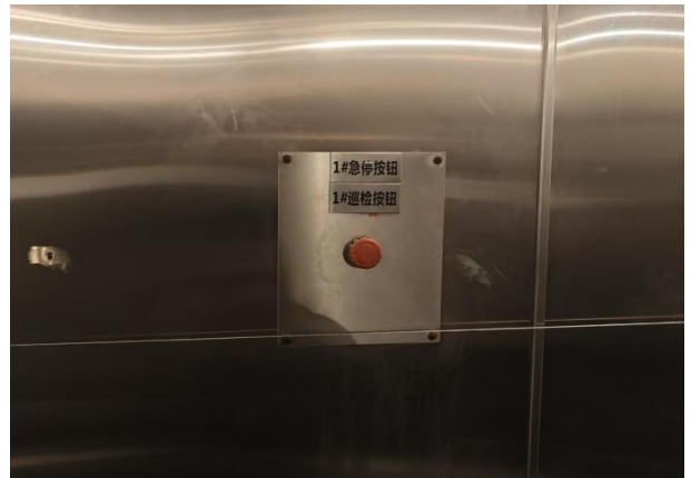
辐照车间内急停按钮 1
