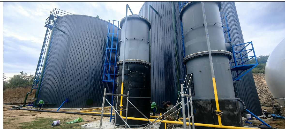
厌氧消化罐、沼气净化器
