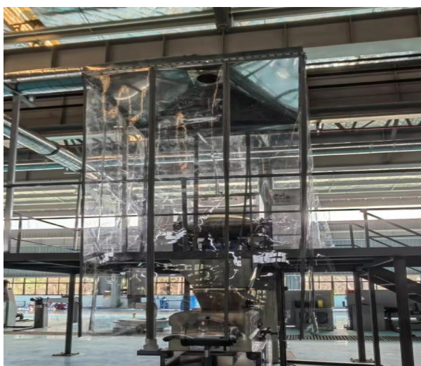
废气收集设施
