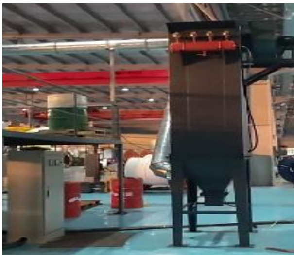
上料粉尘废气配套除尘器
