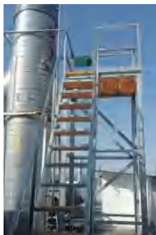
废气采样平台
