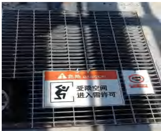
地埋事故应急池
