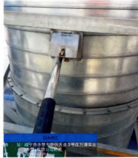
仓库加工区 DA002 辊印、固化废气排气筒 (有组织)
