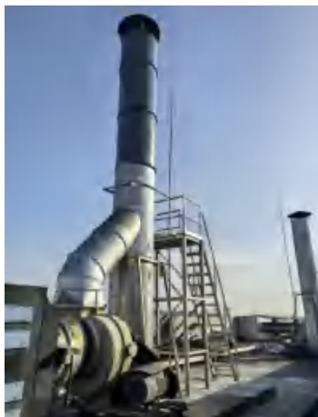
4#厂房排气筒及废气处理设施
