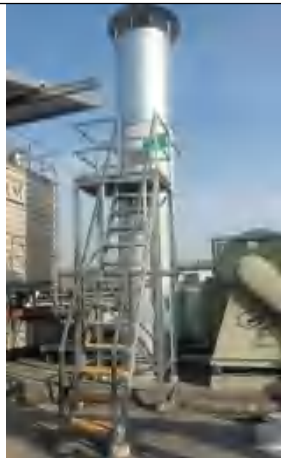
3#厂房废气处理设施
