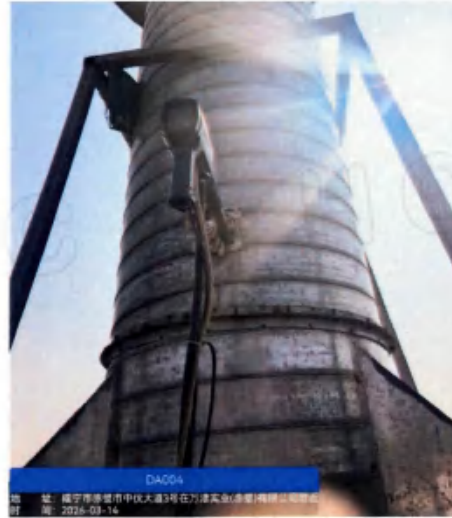
3#厂房 DA004 丝印、固化废气排气筒 (有组织)
