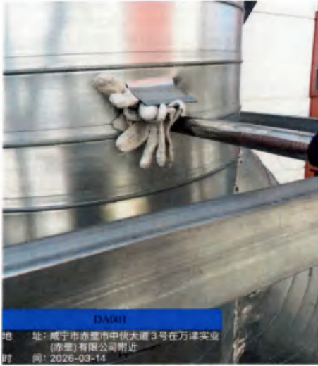
仓库加工区 DA001 辊印、固化废气排气筒 (有组织)
