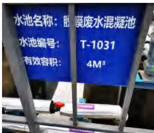
脱膜废水混凝池
