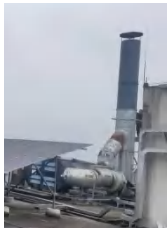
4#厂房排气筒及废气处理设施
