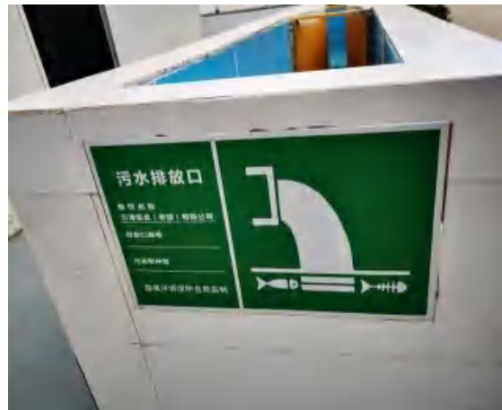
废水排口标识 (DW001)
