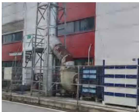
仓库加工区排气筒及废气处理设施
