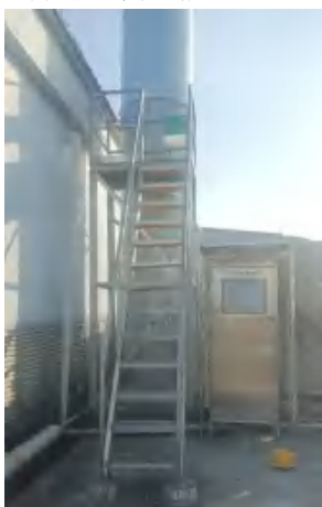
3#厂房废气处理设施
