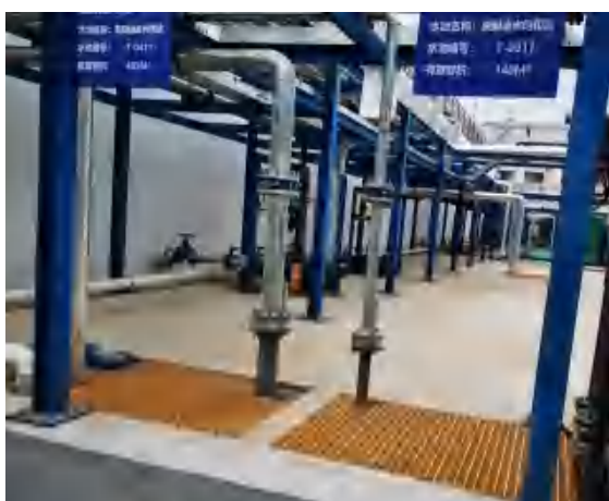
高浓废水均和池及脱膜废水均和池
