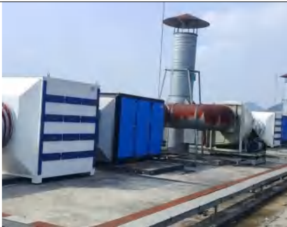
3#厂房排气筒及废气处理设施
