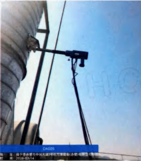
3#厂房 DA005 丝印、固化废气排气筒 (有组织)
