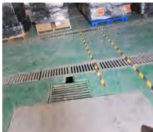
危废暂存间收集池及导流沟
