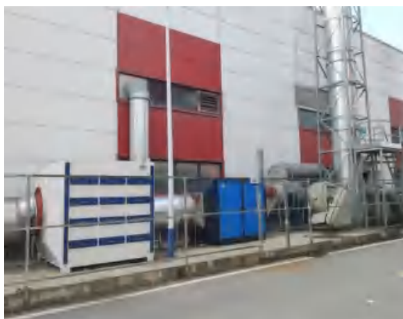
仓库加工区排气筒及废气处理设施
