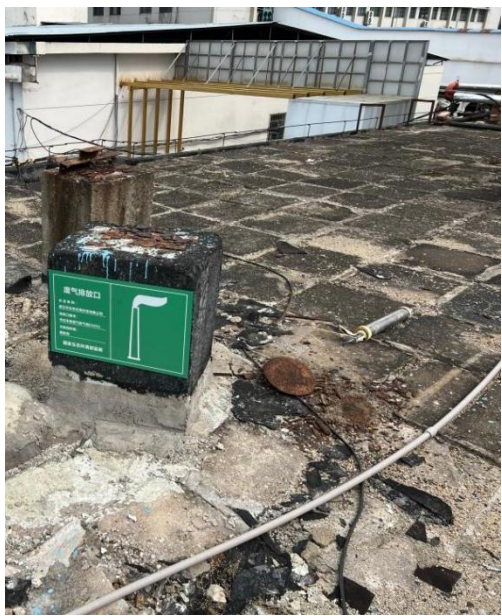
中试车间干燥废气排气筒，编号 DA003
