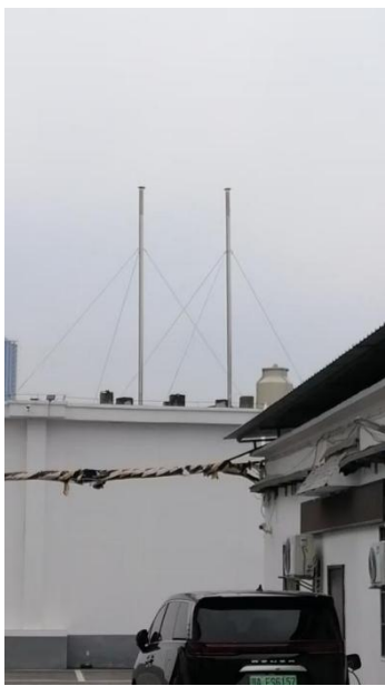
中试车间 2 根废气排气筒
