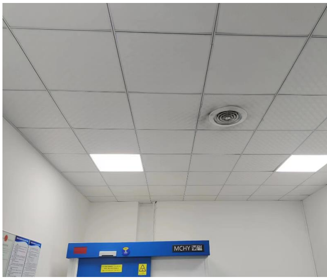
检测室机械通风系统
