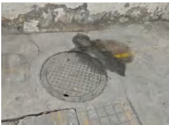
本项目依托化粪池
