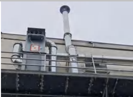
废气排气筒及废气处理设施
