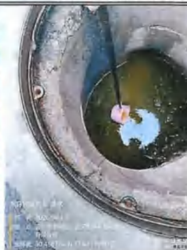
★1 全厂废水总排口 W1
