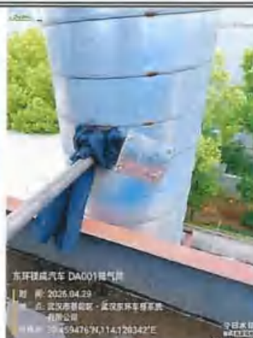
◎1 DA001 废气排气筒
