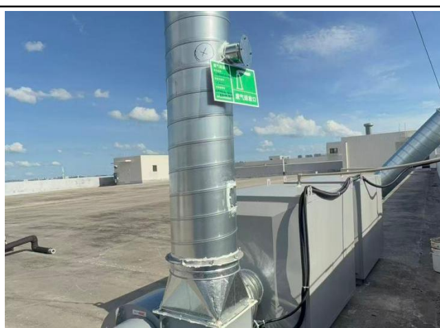
喷涂排气筒采样口及标识牌（DA001）
