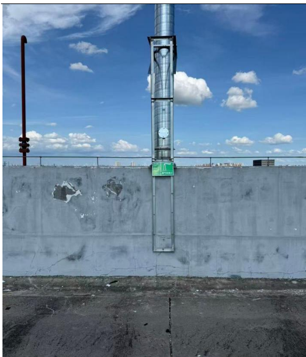
养护废气排气筒及标识牌（DA002）
