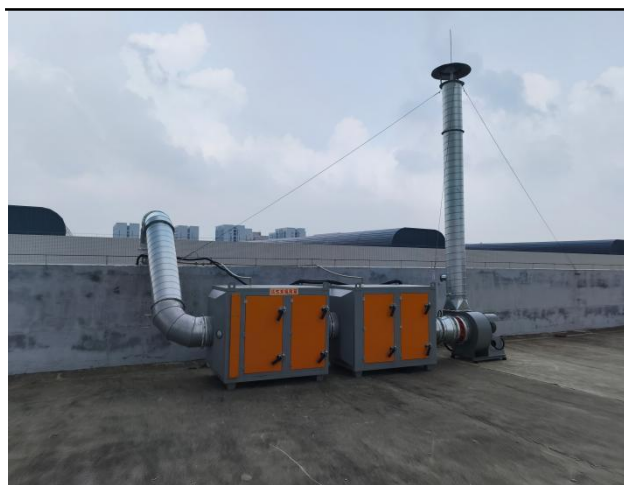
二级活性炭装置及喷涂排气筒（DA001）
