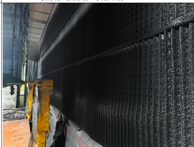
喷涂工位测吸风装置及过滤棉
