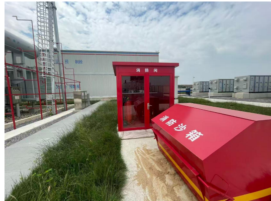
消防水箱及消防沙箱
