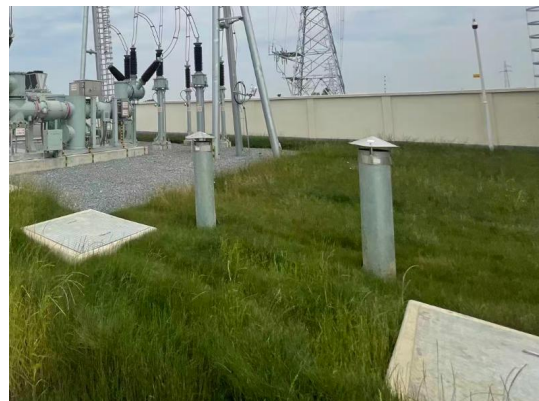
地下事故油池
