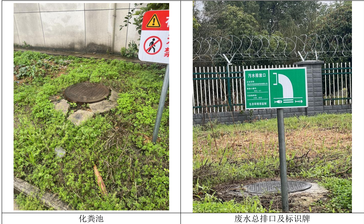
图 12 项目废水防治措施现场照片
